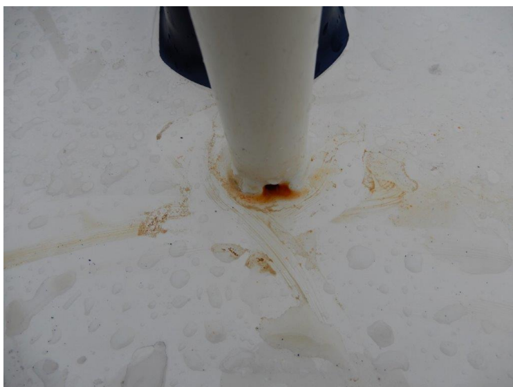
Roest water sporen op verschillende plaatsen. Binnenzijde zou bijvoorbeeld niet geconserveerd kunnen zijn
