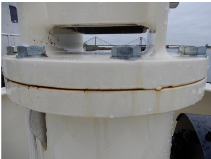
Roest sporen tussen de flens van de spijkbare mast
