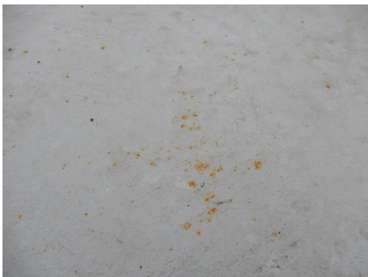
Roest beschadigingen in het lakwerk van het dek
