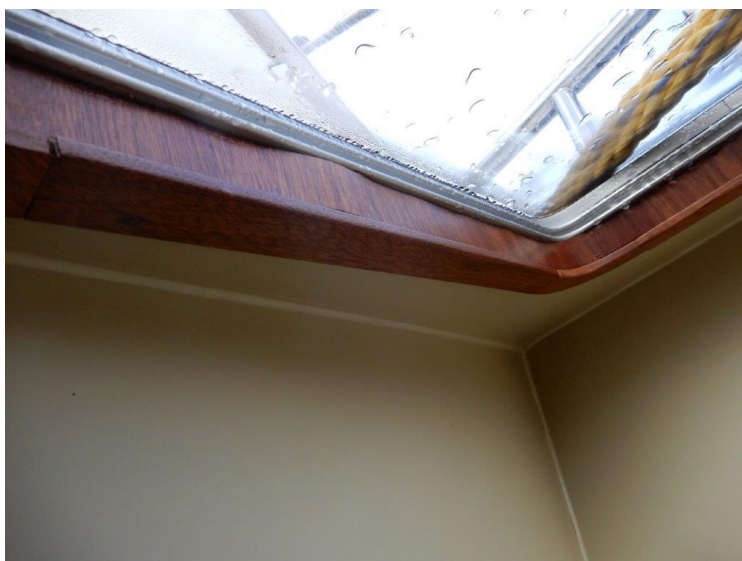
Houtwerk laat na 1 week bewoning al los
