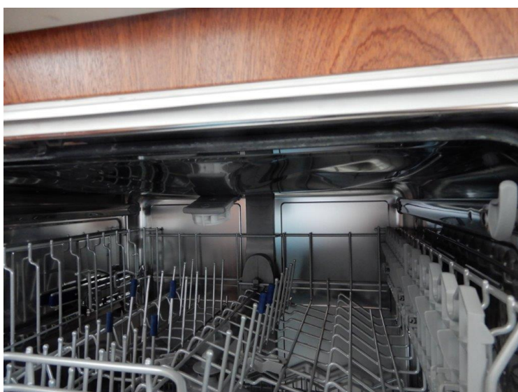
Bovenzijde van de vaatwas machine is ingedeukt. Beschadigd gemonteerd
